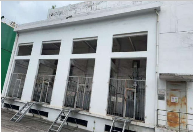
依托厂区配电设施
