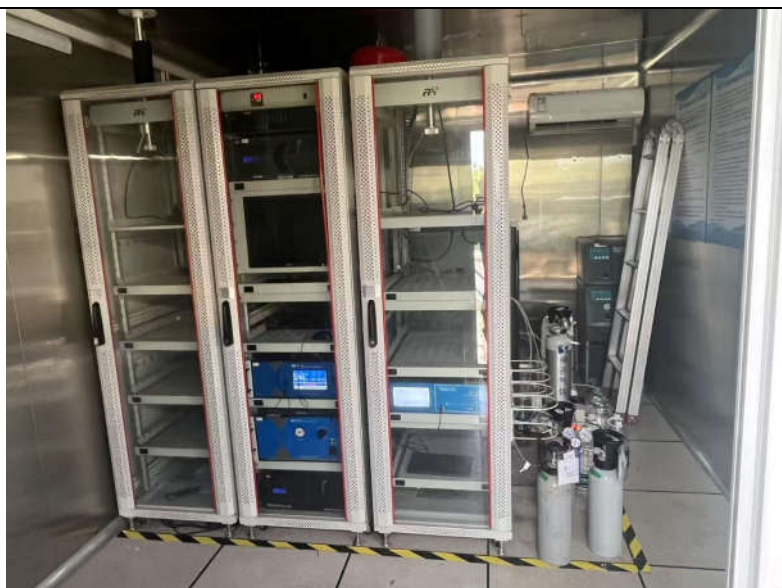
图 3-5 依托厂区现有挥发性有机物环境监测在线监测设施现场照片
