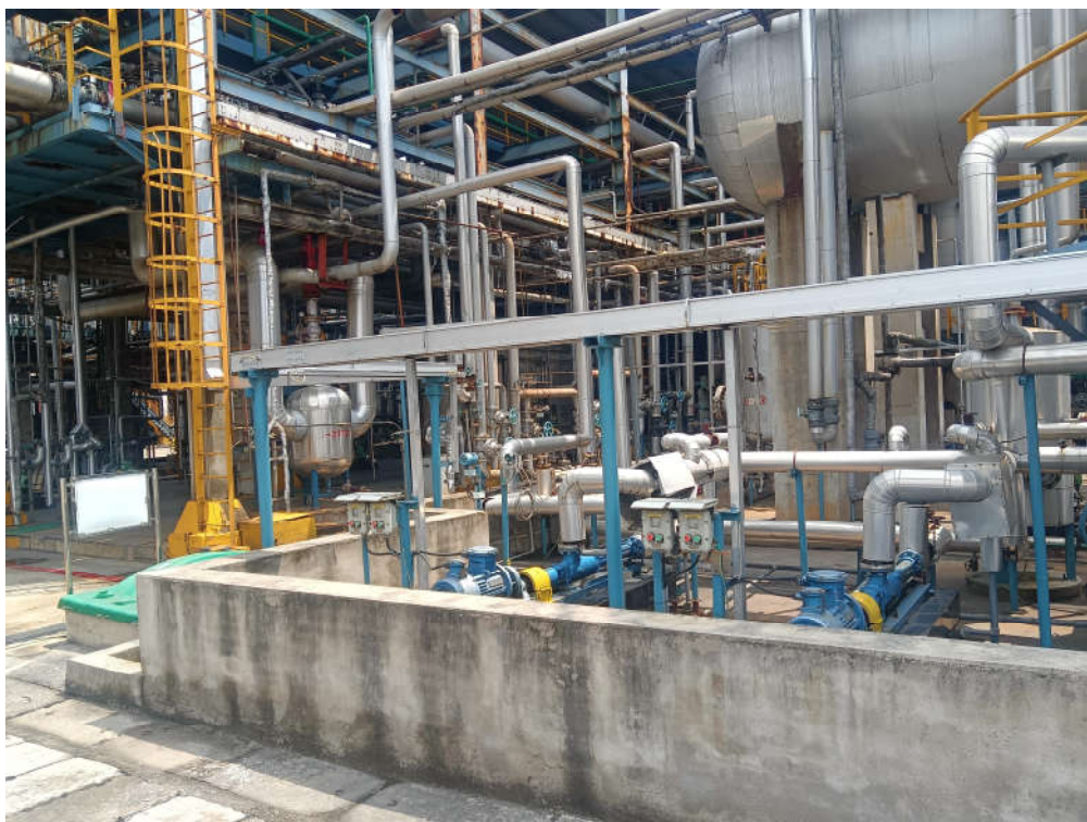
图 3-2 固废综合利用场地至依托 2#焦化装置密闭运输管线系统现场照片
