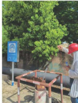
SK4 地下水监测井
