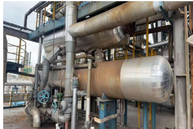
依托厂区蒸汽系统
