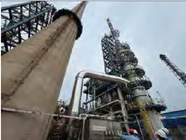
8 万吨/年 3#硫磺回收装置排气筒
