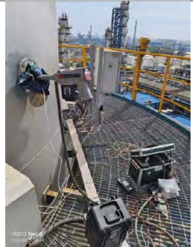
3#催化裂化装置废气脱硫脱硝排放口采样孔
