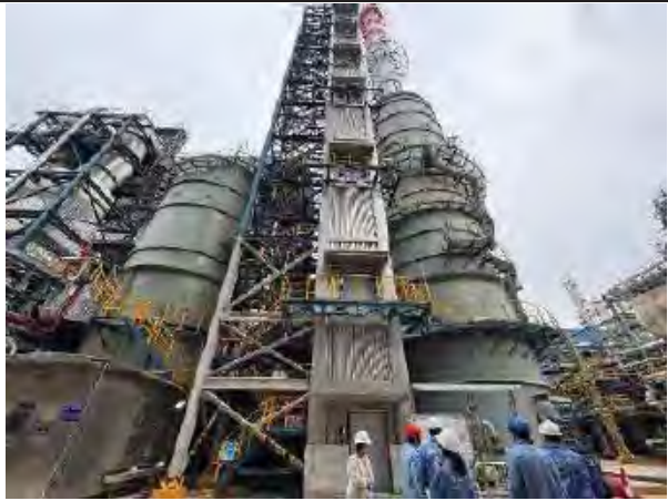
3#催化裂化装置烟气脱硫设施
