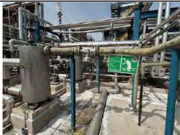
3#催化裂化装置含镍废水处理设施排放口（DW022）
