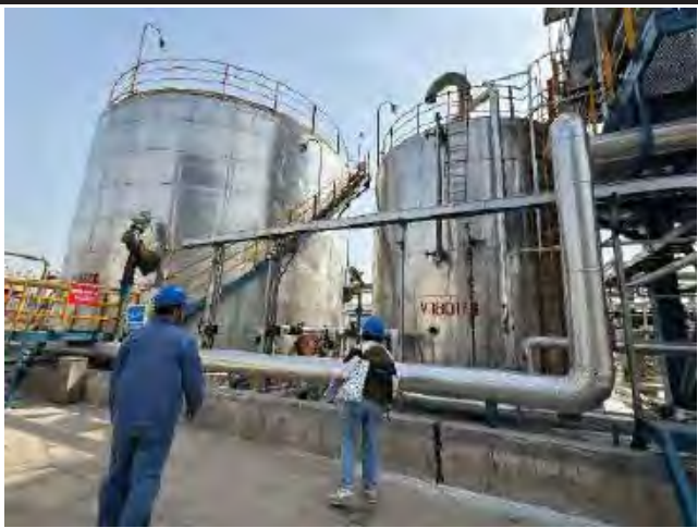
3#催化裂化烟气脱硫含镍废水处理设施（氧化单元）
