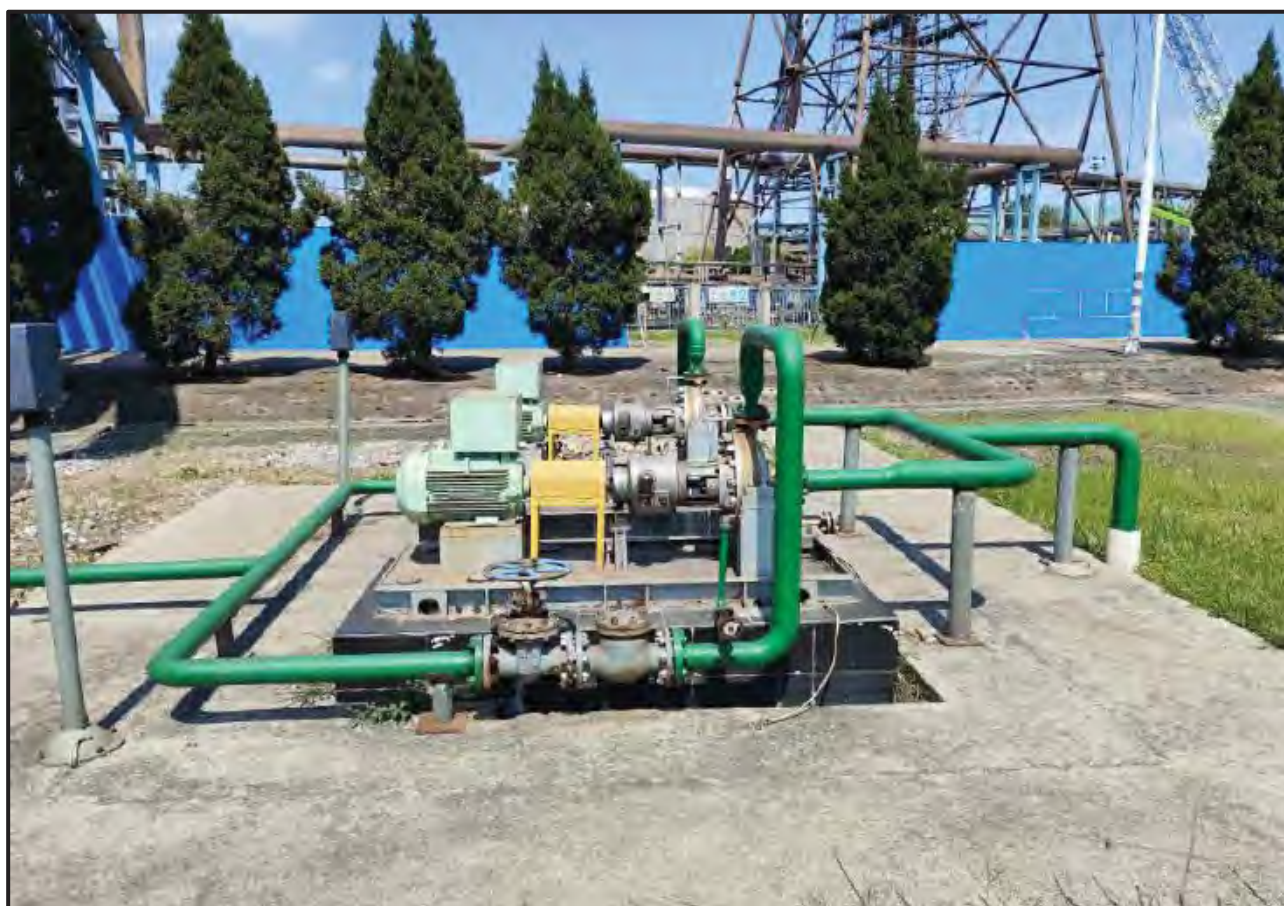
图 9-3-1 火炬区域地下水井配套抽水设施
