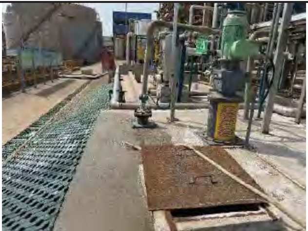
3#催化裂化装置含镍废水处理设施采样口
