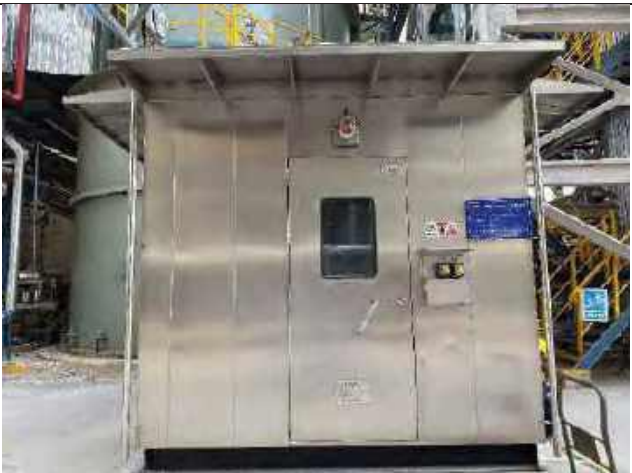
3#催化裂化装置废气脱硫脱硝排放口在线监测站房
