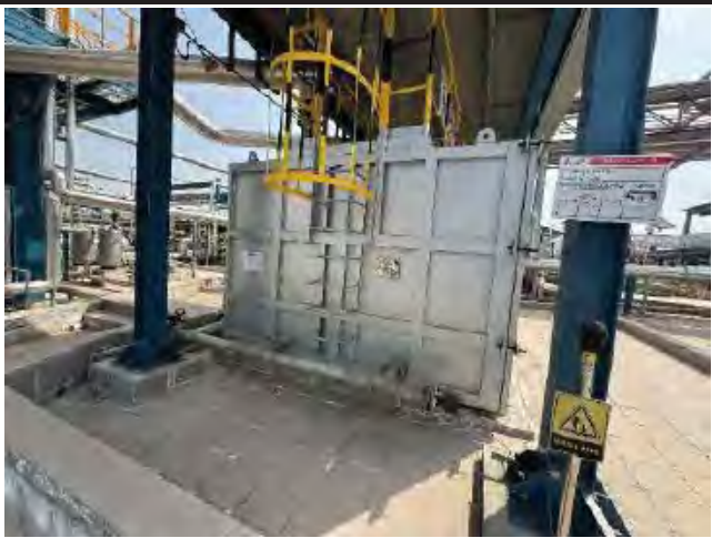
3#催化裂化烟气脱硫含镍废水处理设施（过滤单元）
