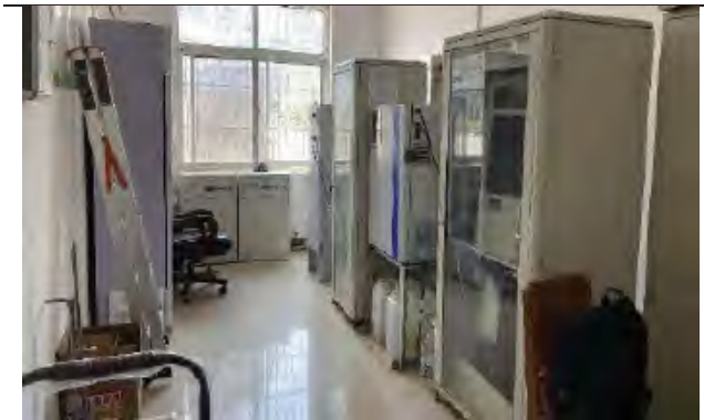
北明沟雨水排口在线站房
