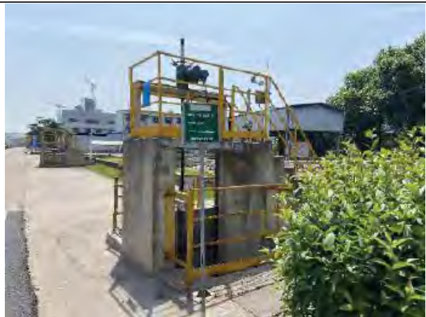
北明沟雨水排口（DW011）闸阀
