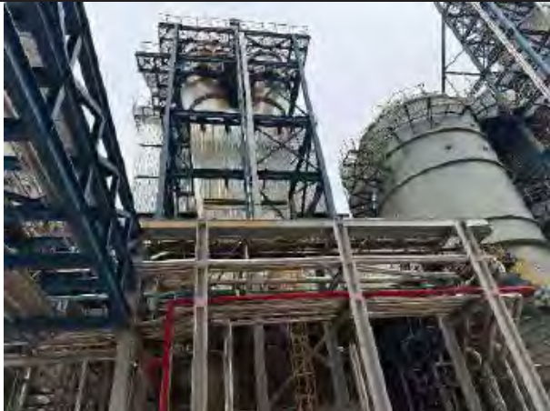
3#催化裂化装置烟气除尘设施
